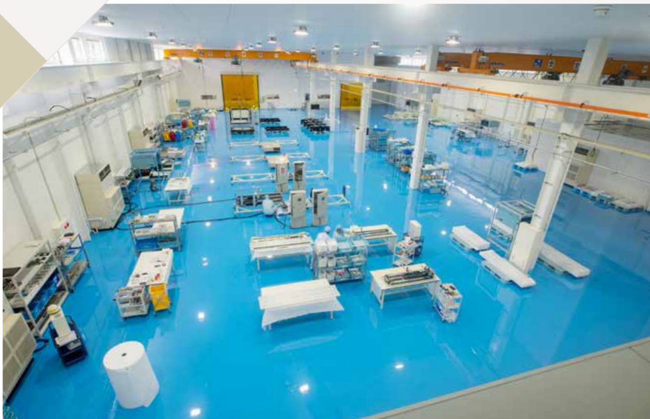
クリアパーク延岡工場 組立棟(クリーンルーム) 30m×50m 天井クレーン 吊り代5m
