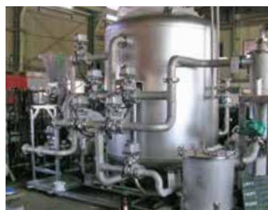
水処理タンク及び配管
